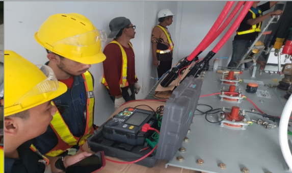
TEST COM TRAFO 1250 KVA
